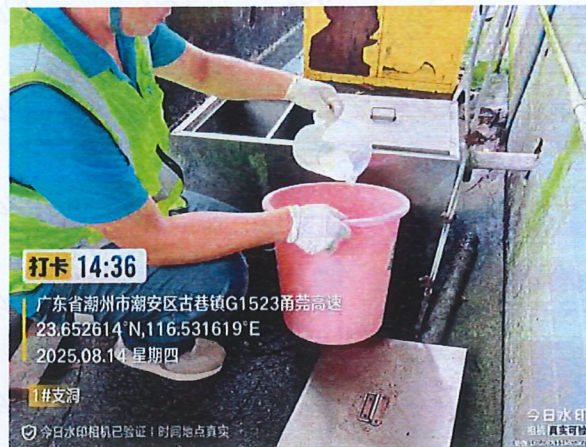
施工 1 标 1#支洞厨房生活污水
