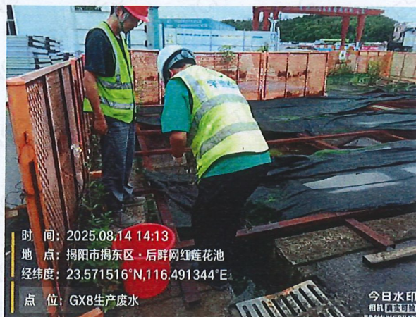
施工 2 标 GX8 生产废水
