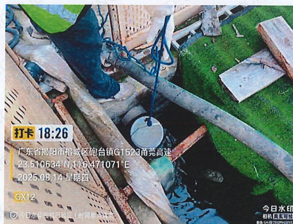
施工 2 标 GX12 生产废水
