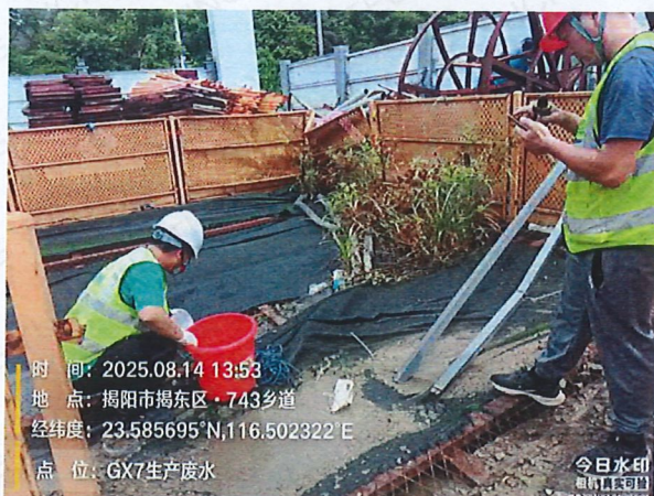
施工 2 标 GX7 生产废水
