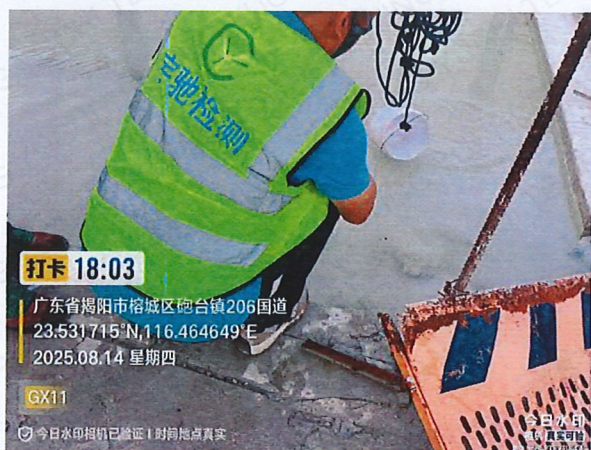
施工 2 标 GX11 生产废水
